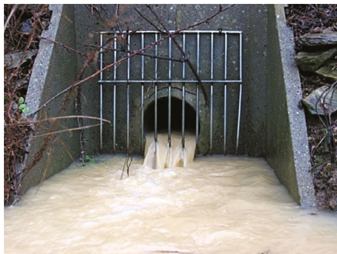
Obr. 9: Výtokové otvory podpovrchovej drenážnej sústavy
